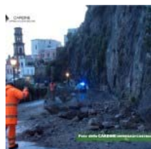
Foto 1, Frana in roccia loc. Castiglione di Ravello (foto della CARDINE SRL)
