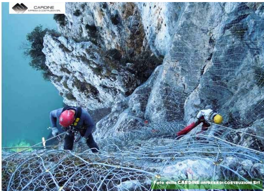
Foto 6, posa in opera di rete in acciaio zincato (foto della CARDINE SRL)
