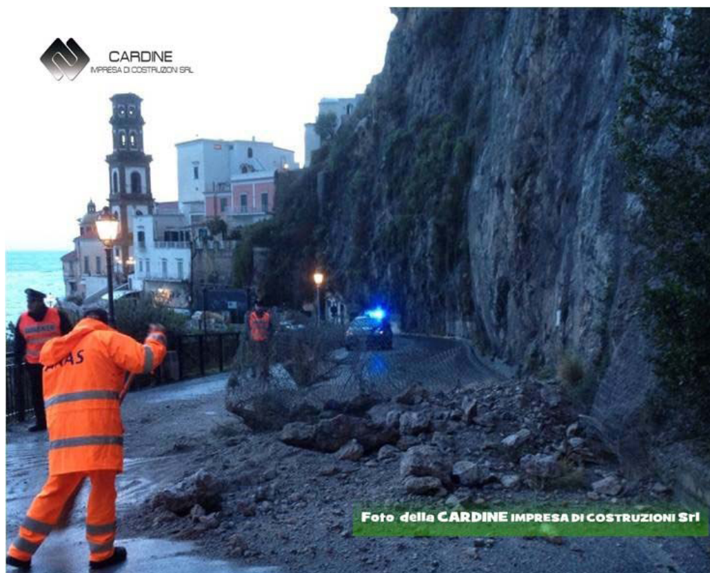
Foto 1, Frana in roccia loc. Castiglione di Ravello (foto della CARDINE SRL)
